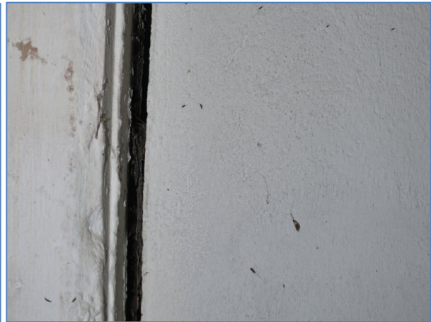
Abb. 22 Quartierspalt mit Fledermauskot an der Wand
