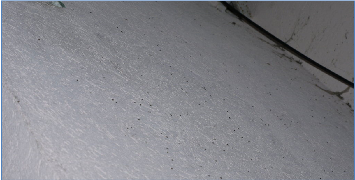
Abb. 23 Fledermauskot im Bereich eines Koloniequartiers
