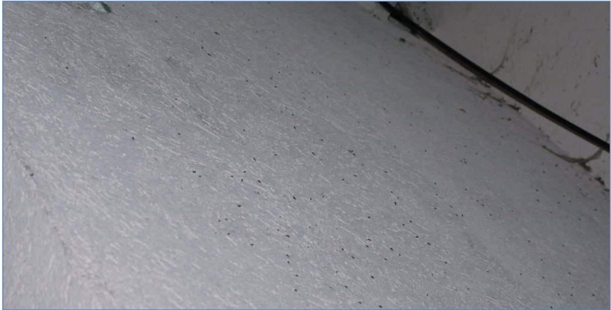
Abb. 23 Fledermauskot im Bereich eines Koloniequartiers
