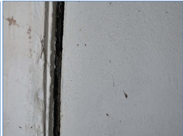
Abb. 22 Quartierspalt mit Fledermauskot an der Wand
