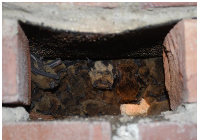
Abbildung 6: Hauptwinterquartier von Pipistrellus spec. hinter losem Stein unter der SO-Treppe. A. Petzold, 19.02.2012
